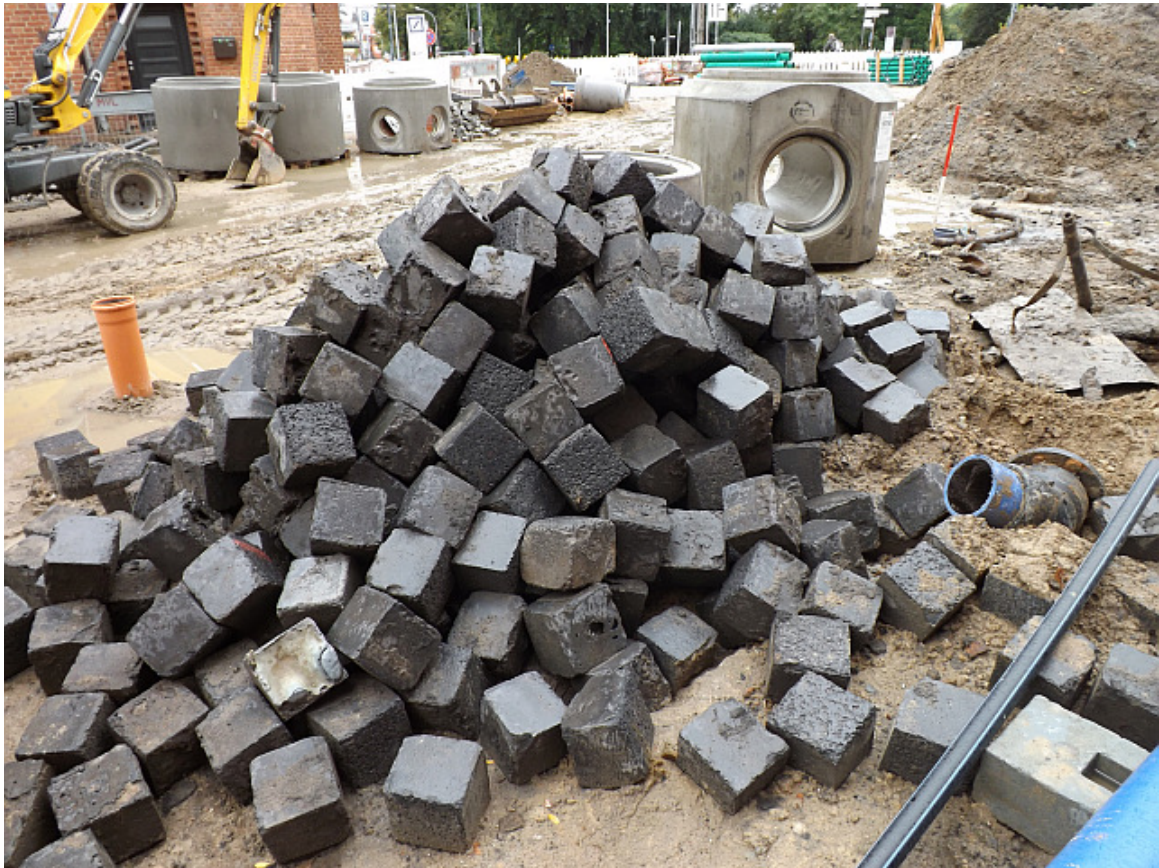
Abb. 3: Im Rahmen von Kanalarbeiten entfernte und aufgehäufte Schlackensteine aus Mansfelder Kupferschlacke
